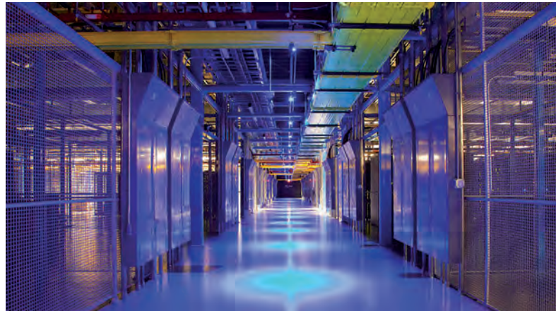
Innovativ und nachhaltig: Blick in ein Equinix-Rechenzentrum. Quelle: Equinix (Germany) GmbH
