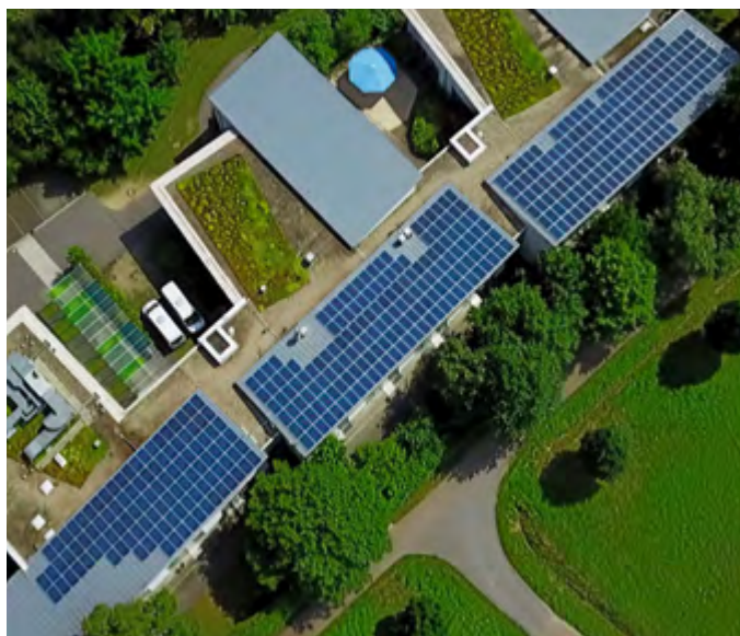
Photovoltaikanlage Mosaikschule Foto: ABl, Abteilung Energiemanagement
