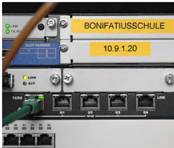
Netzwerkschrank Bonifatiuschule Foto: ABI, Abteilung Energiemanagement
