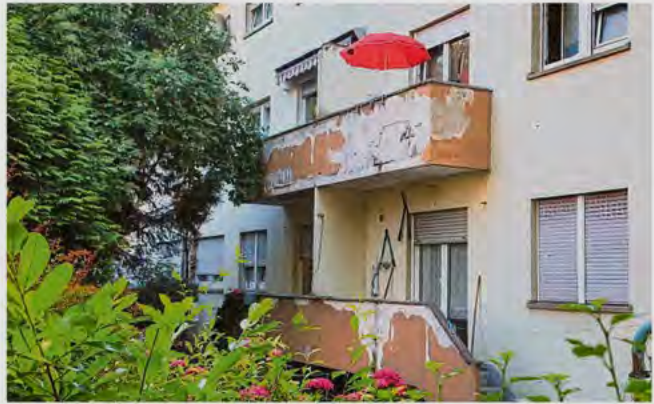
Kein schöner Anblick: Bröckelnde Fassaden in der Carl-von-Weinberg-Siedlung.
