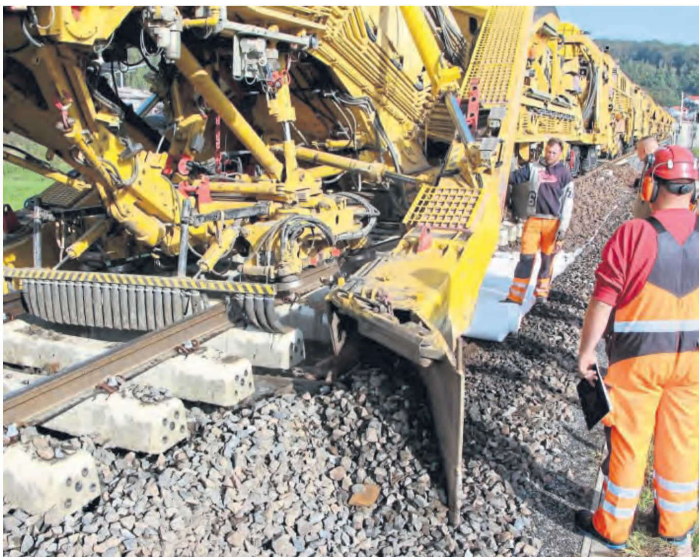
Gleisumbauarbeiten: Ein mächtiger Bauzug erneuert auf der Bahnstrecke zwischen Frankenberg und Vierrmünden (Foto) Schienen, Schwellen und Schotter. Das Vlies soll Feuchtigkeit aus dem Gleisbett zurückhalten. FOTO: KLAUS JUNGHEIM
