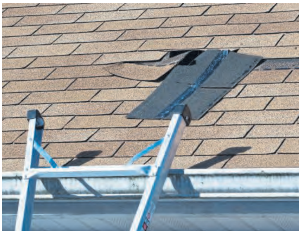
Wenn starker Wind ein Leck verursacht, sollte das schnell repariert werden, damit keine Feuchtigkeit eindringen kann. FOTO: PANTHERMEDIA / ARENACREATIVE
