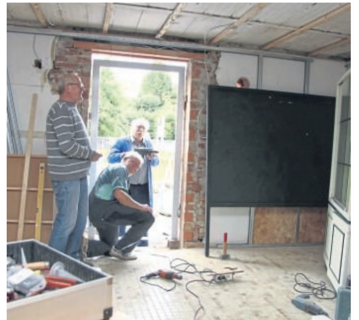
Der frühere Dorfladen wird zum Veranstaltungsraum umgebaut. Hier bauen (von links) Ottmar Kleppe, Peter Ulbricht und Dieter Mrozik eine Tür ein. FOTOS BERND SCHÖNEMANN
