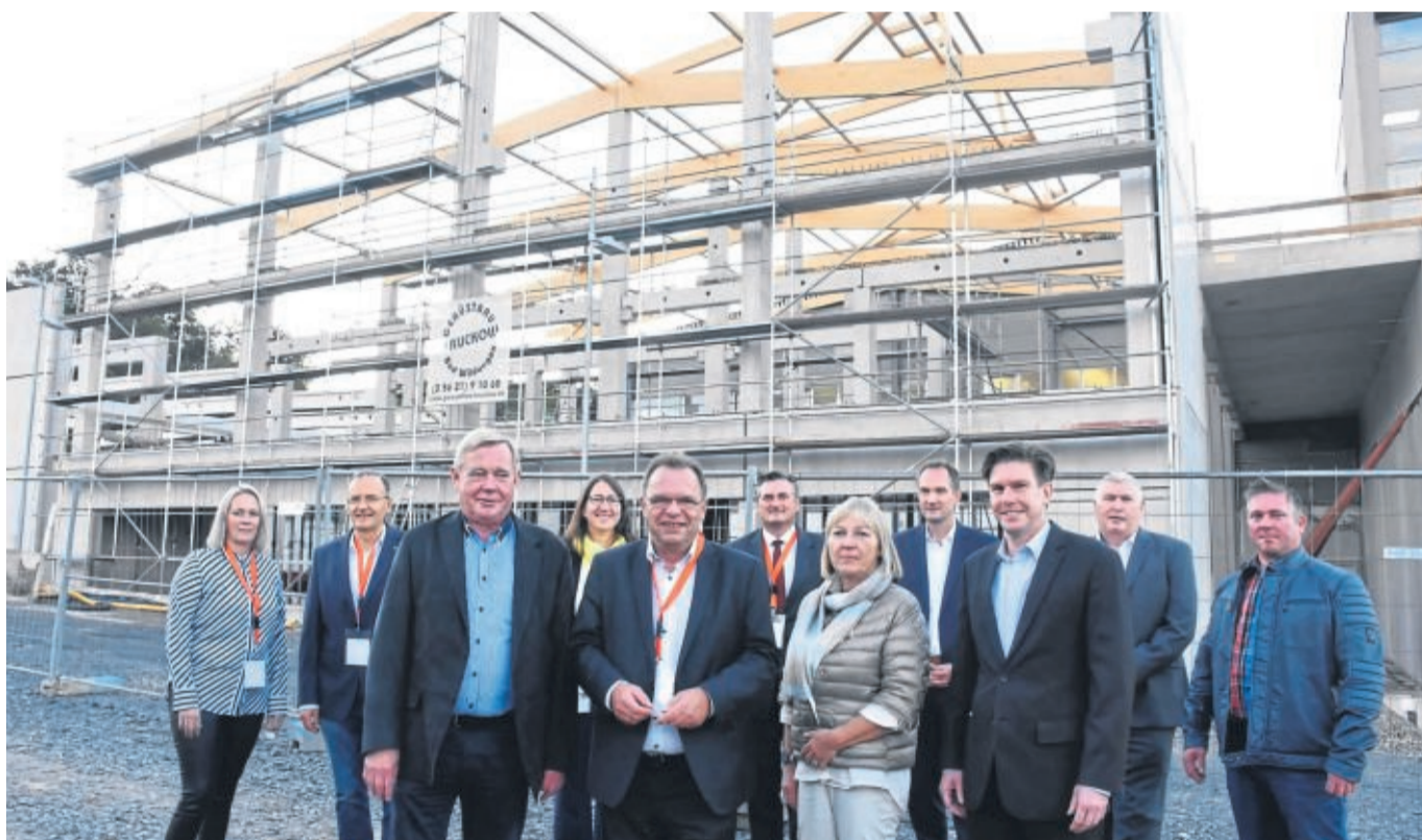
Sie besichtigten die Baustelle: vorn von links Investor- und Vermietervertreter Karl Kördel, Landrat Winfried Becker, Ellen Kördel-Heinemann, Bernd Arnold, dahinter Guxhagens Bürgermeisterin Susanne Schneider, Handwerkskammer-Präsident Frank Dittmar, Ariane Rindlisbacher, Dr. Arnd Klein-Zirbes, Thorsten Peuker, Jens Karl und Prokurist Kai Kördel.
