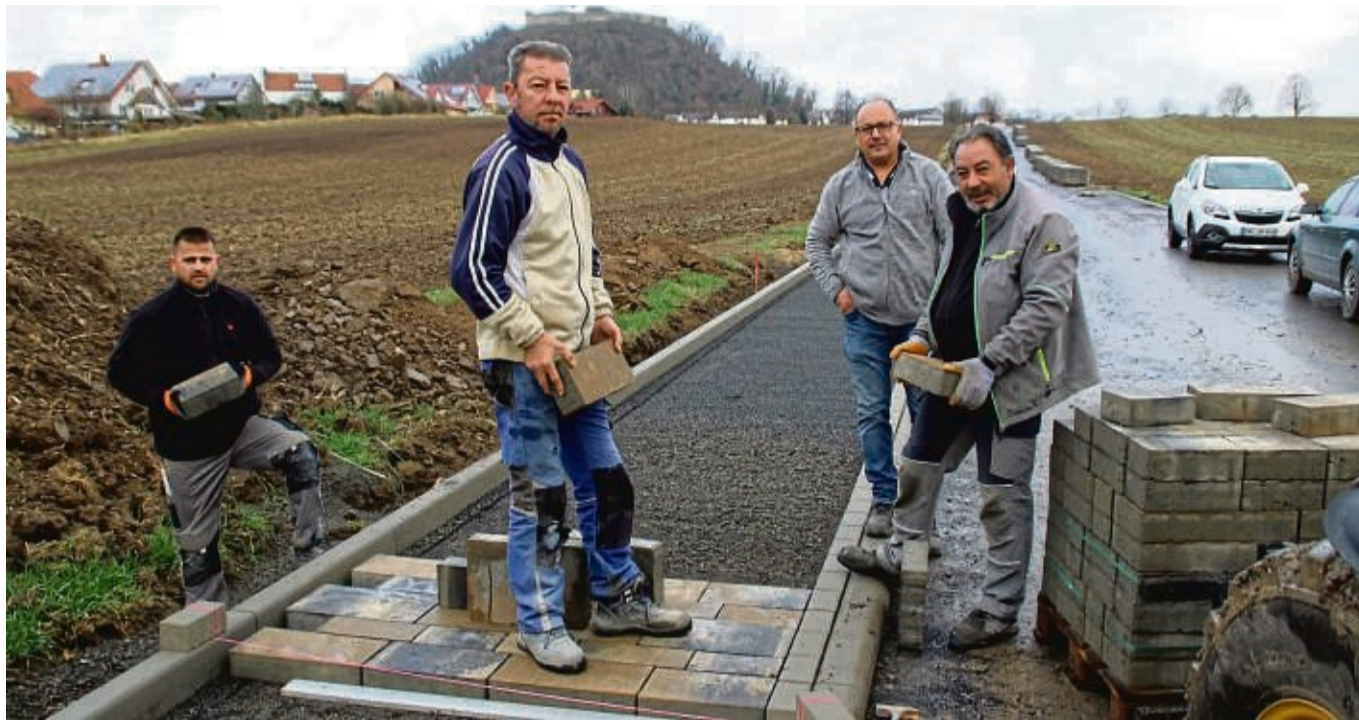
Die künftige Zufahrt zum neuen Baugebiet für Gudensberg: Das Team eines Bauunternehmens aus Morschen führt für die Stadt Gudensberg die gesamten Erschließungsarbeiten aus. Im Bild von links Metin Ramazano, Gürcan Duko, Polier Hasan Kizilkaya und Sunay Ahmet beim Verlegen des Betonpflasters für den Gehweg.
