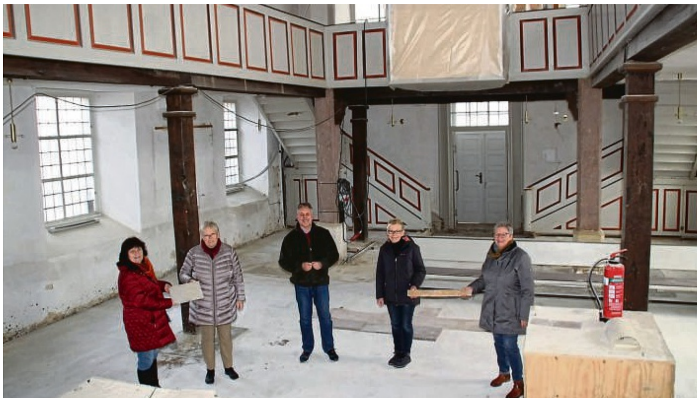
Freuen sich über den guten Baufortschritt bei der Instandsetzung der Friedenskirche in Böddiger: von links Sabine Landesfeind, Hannelore Trebing, Ernst Friedrich Schluckebier, Jutta Kunz und Marga Bartholmai.
