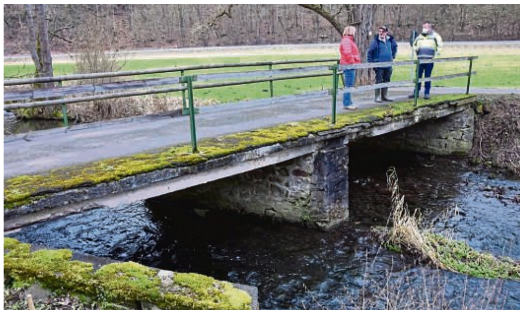
Dass die Brücke beschädigt ist, darin sind sie sich einig: Ortsvorsteherin Christine Scheffer, Anwohner Peter Fischer und Bauamtsleiter Volker Denhof begutachten den Zustand der Brücke Scheuermühle bei Herzhausen. FOTO: STEFANIE RÖSNER
