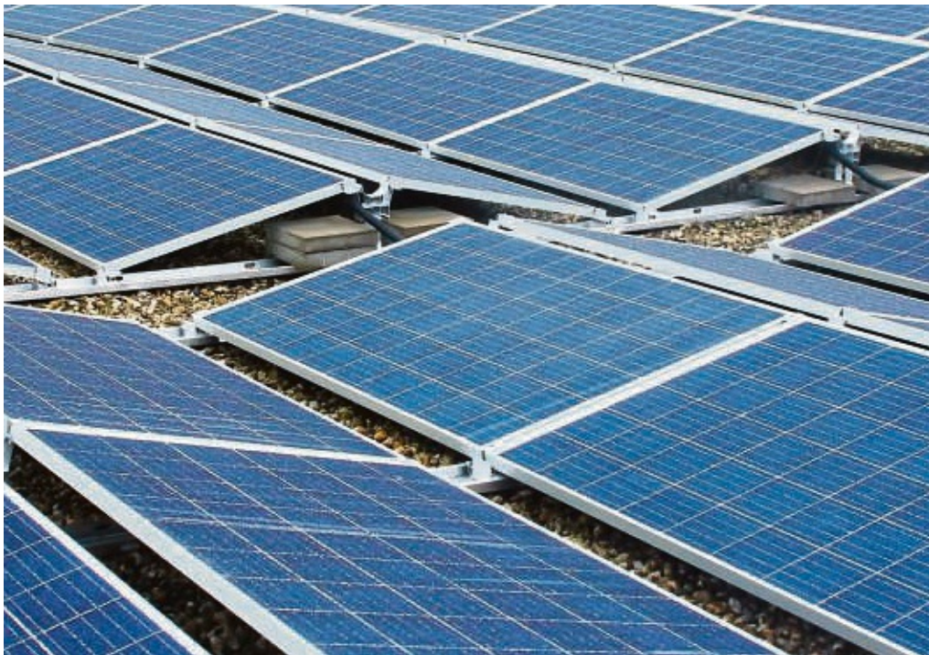
Stromerzeugung auf dem Dach: Nicht immer werden Fotovoltaikanlagen genehmigt, weil die Netze teilweise an ihre Grenzen stoßen.
