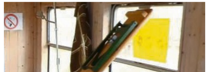
Ein Fenster muss mit einer Sitzbank gegen das Herausfallen gesichert werden.
