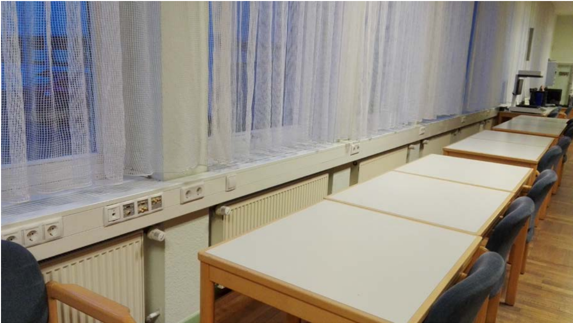
Abb. 6: Steckdosen in der Fensterreihe (Foto: eigene Aufnahme).
