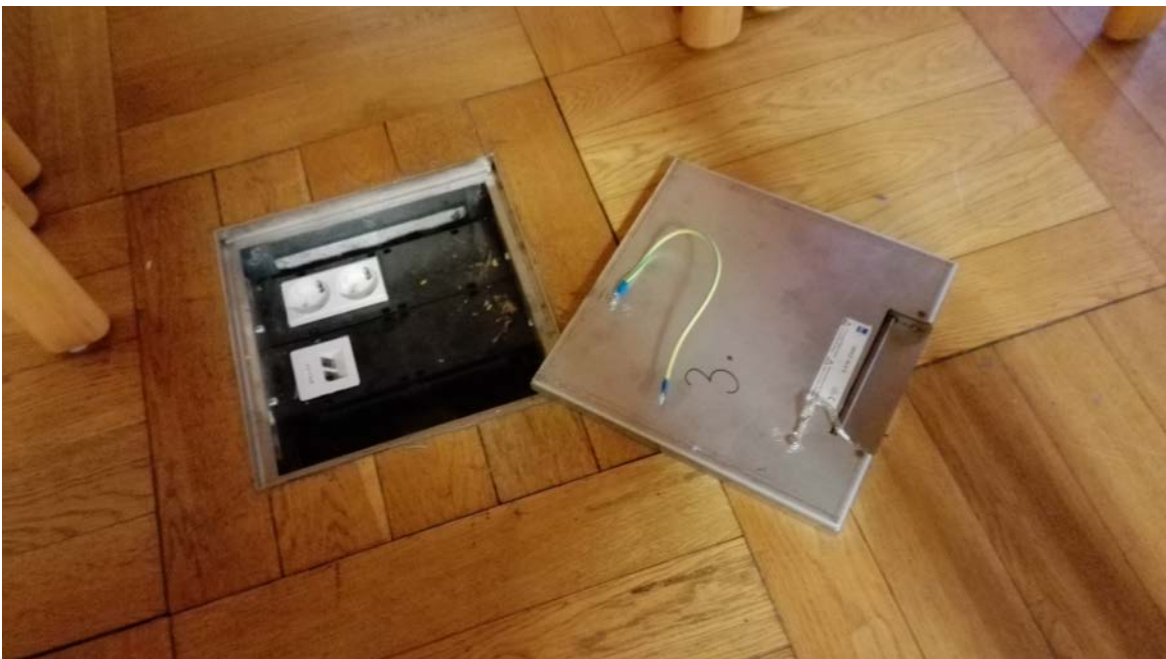
Abb. 7: Bodentank mit je zwei Steckdosen und einer EDV-Doppel-Anschlussdose (Foto: Elionora Sikora).
