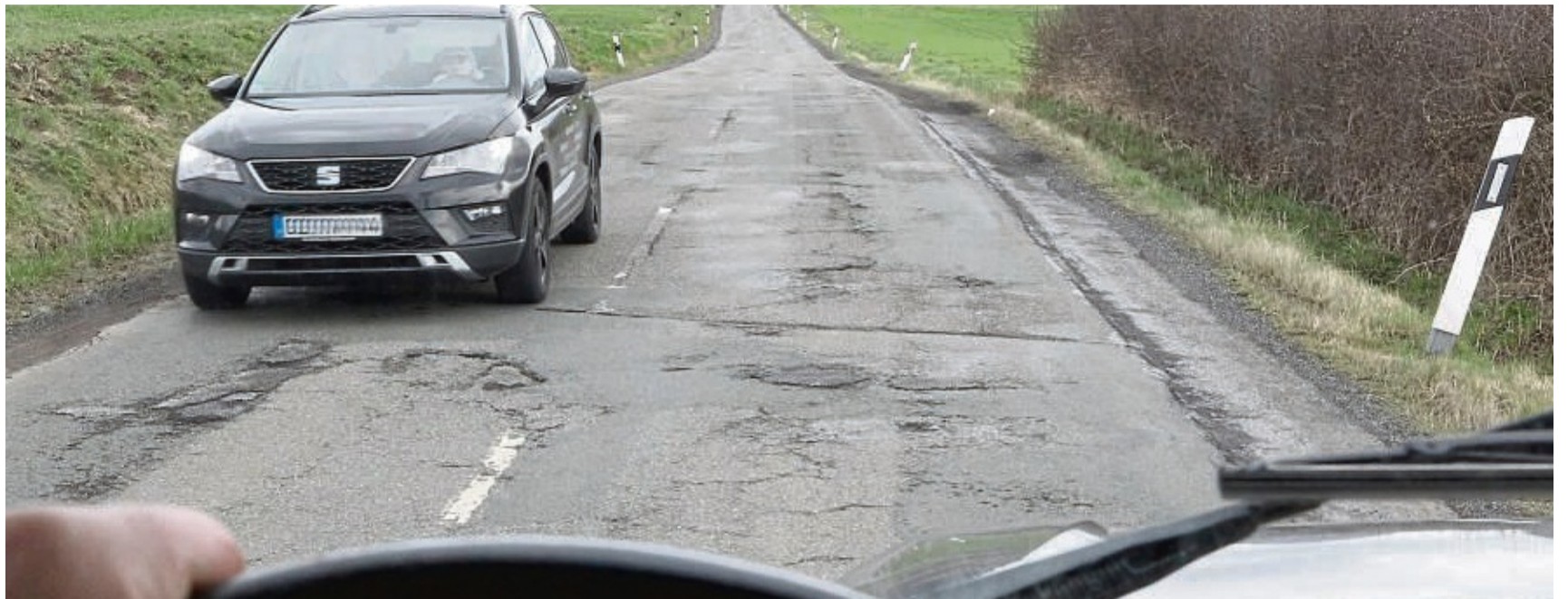
Seit vielen Jahren ein Sanierungsfall: Die Fahrbahn der Landesstraße zwischen Niederelsungen und Nothfelden ist marode, Schlaglöcher wechseln sich mit Rissen und geflickten Stellen ab.
