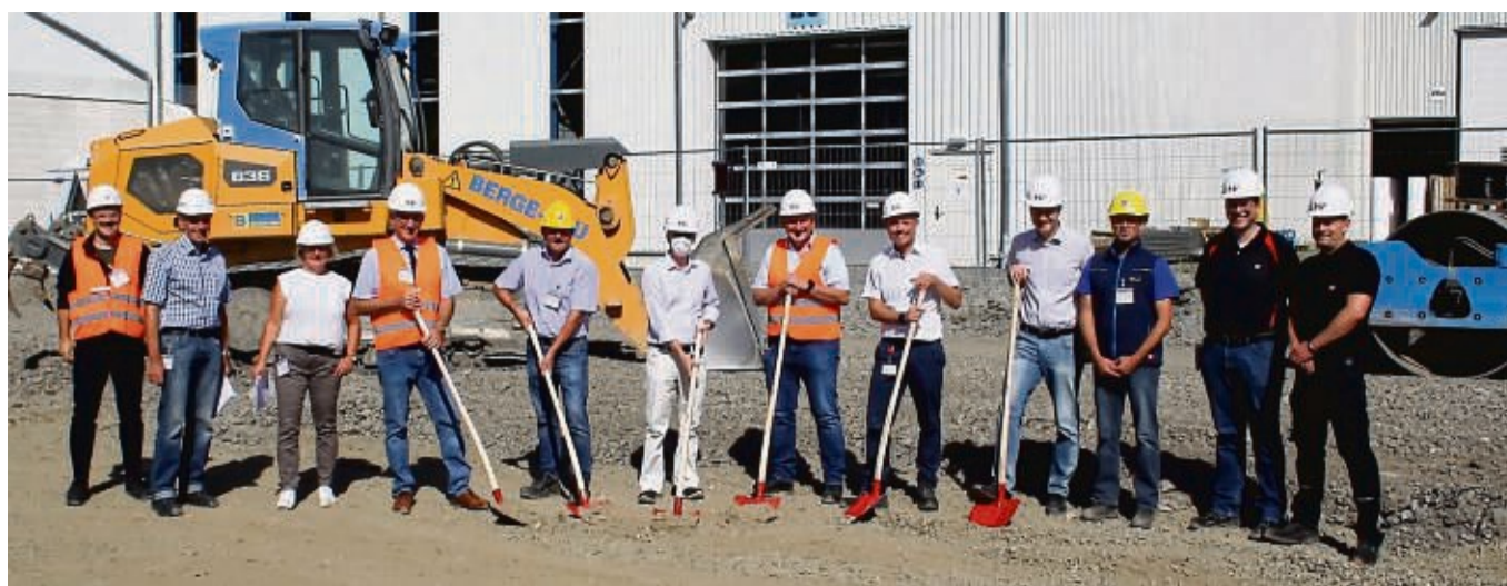
Bei Hollingsworth & Vose in Hatzfeld wird für einen „höheren zweistelligen Millionenbetrag“ eine neue Halle für zusätzliche Produktionslinien gebaut. Am Spatenstich nahmen Vertreter des Unternehmens, der Stadt, des Landkreises, die Architekten und die Baufirma Berge-Bau teil.
