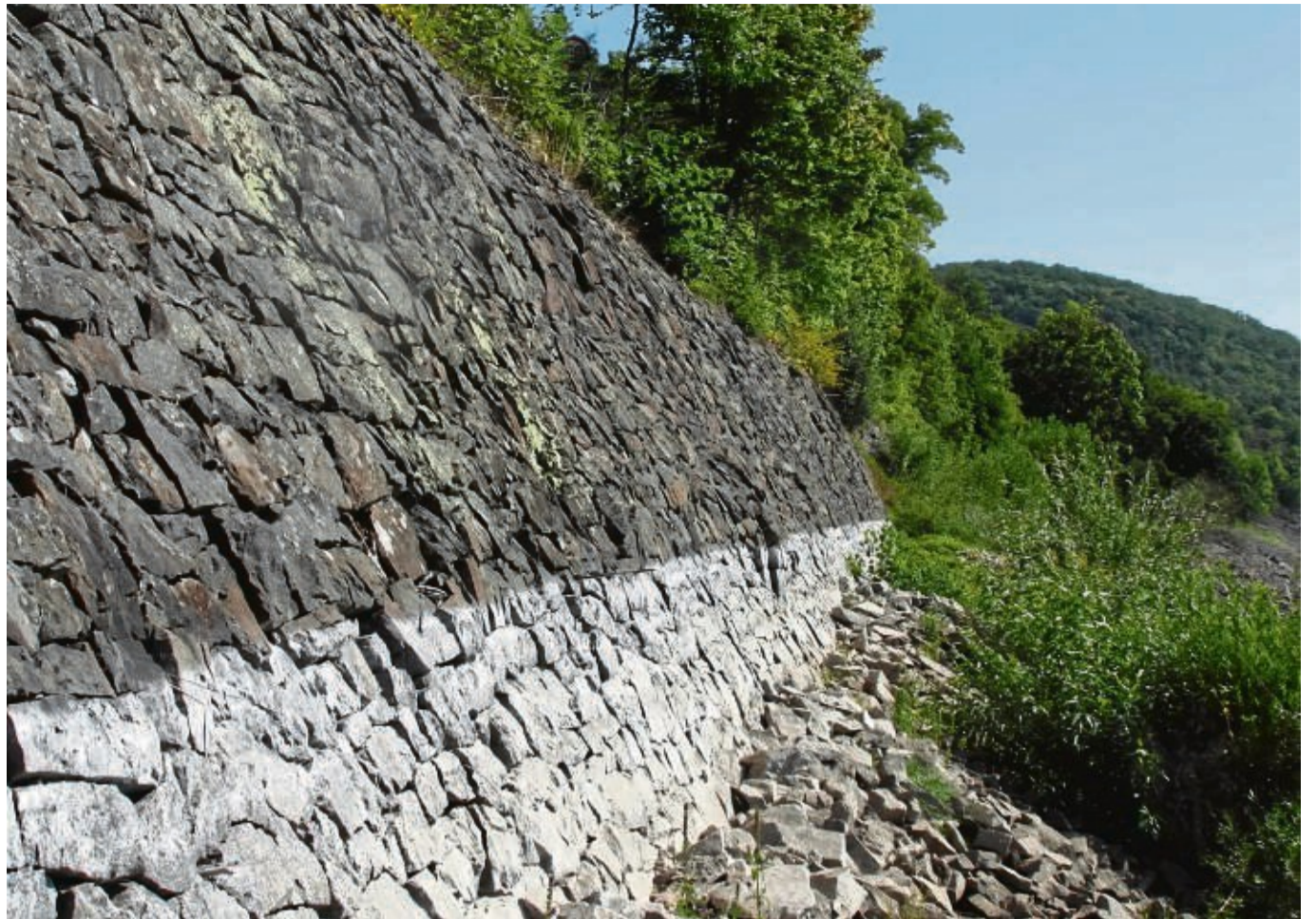
Nicht mehr standsicher: Die Ufermauer am Edersee wird auf einem 120 Meter langen Abschnitt saniert.
