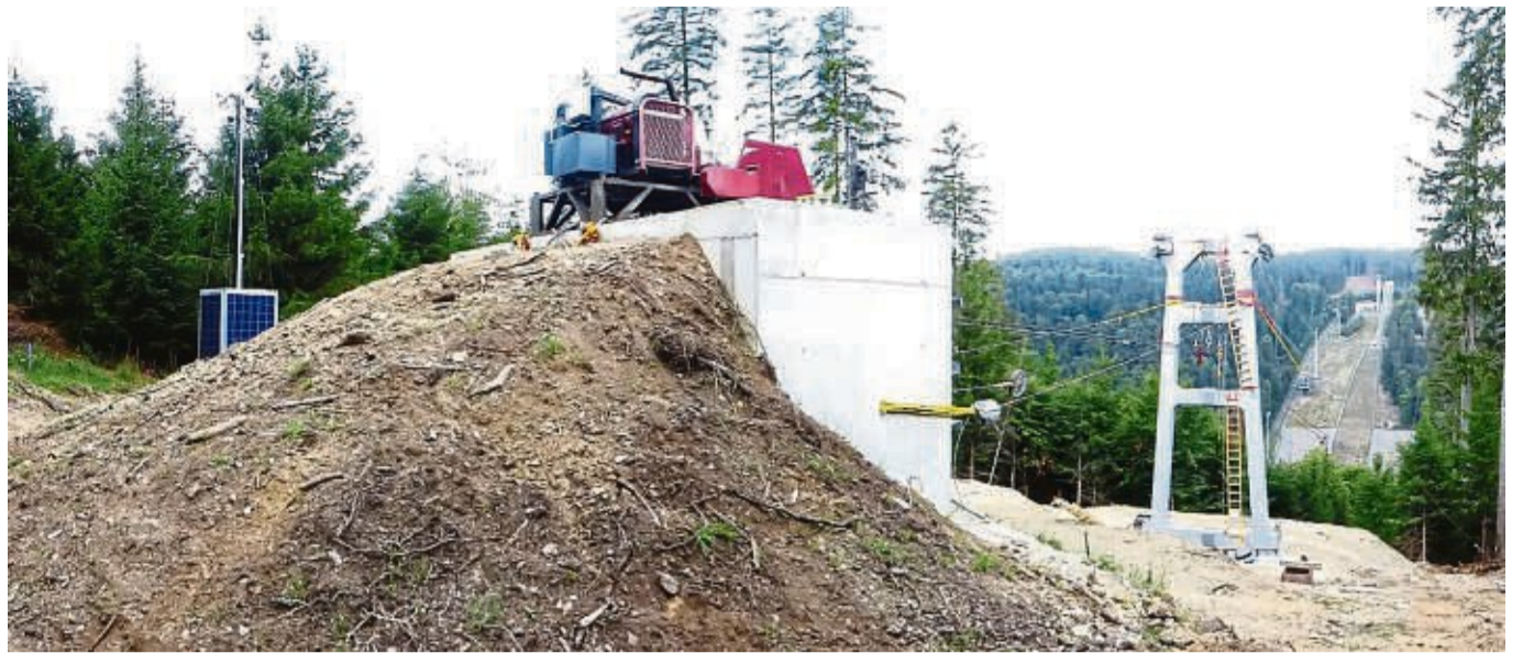
Brücke nimmt Formen an: Das Seil wird über eine speziell errichtete Seilbrücke immer weiter bis auf die gegenüberliegende Seite gezogen.
