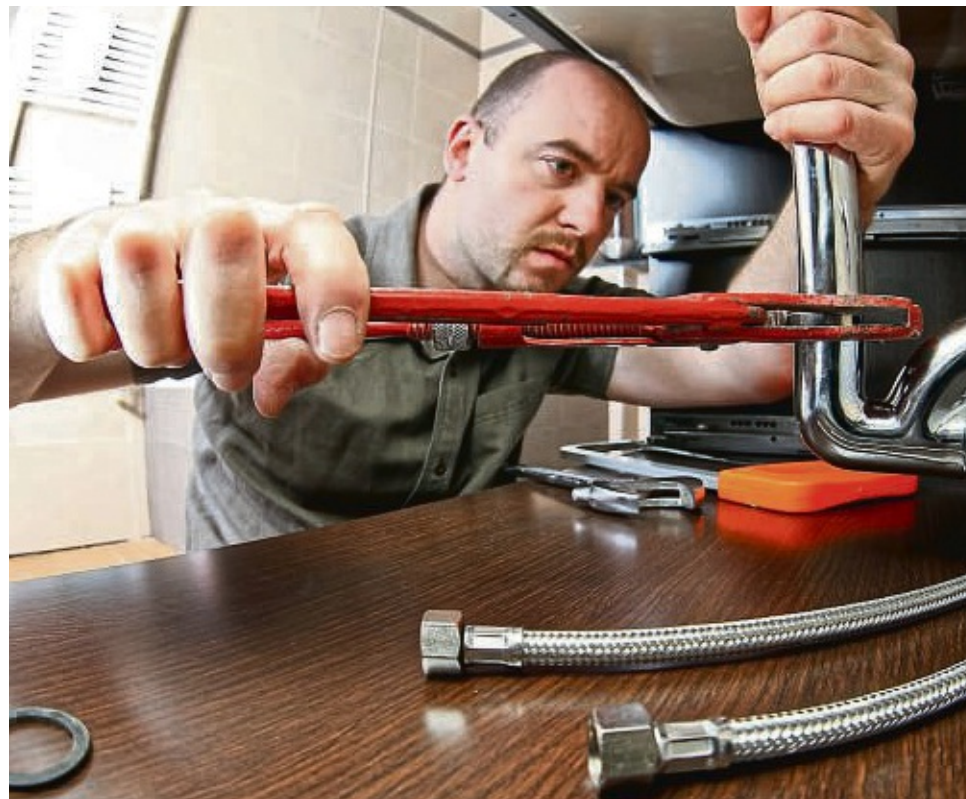
Gerade die Wartezeit auf Klempner kann zu Spitzenzeiten länger ausfallen, als es einem aufgrund dringender Probleme lieb ist.
