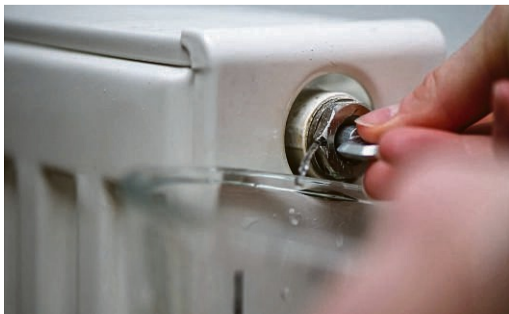
So entlüftet man den Heizkessel: Mit einem Vierkantschlüssel das Ventil an der Seite des Heizkörpers öffnen und so lange offen lassen, bis die Luft entwichen ist.
