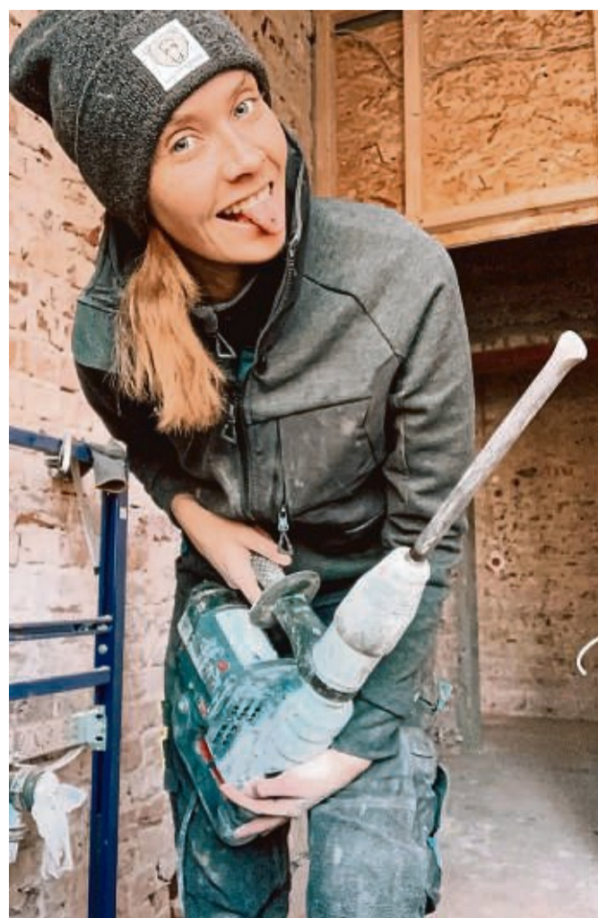
Bohrhammer statt Nagelzange: Sandra Hunke ist Anlagenmechanikerin für Sanitär-, Heizungs- und Klimatechnik.
