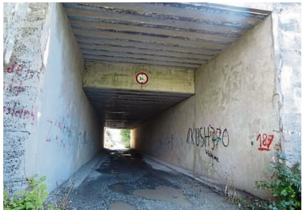
Voller wassergefüllter Schlaglöcher: Die Unterführung unter der Bahnstrecke zwischen Eichenberg-Bahnhof und Hohengandern, die nur für Anlieger freigegeben ist.
