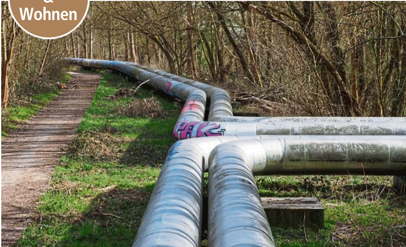
Fernwärme ist eine bequeme Art zu heizen. Doch auch sie wird teurer.
