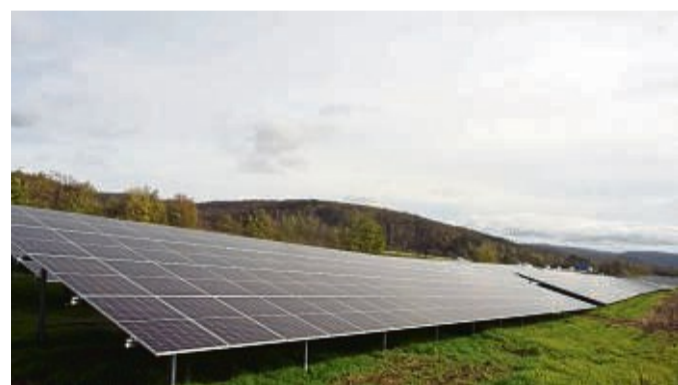
Der Solarpark am Rand des Mündener Ortsteils Hedemünden nimmt Formen an. Die ersten Module sind installiert.
