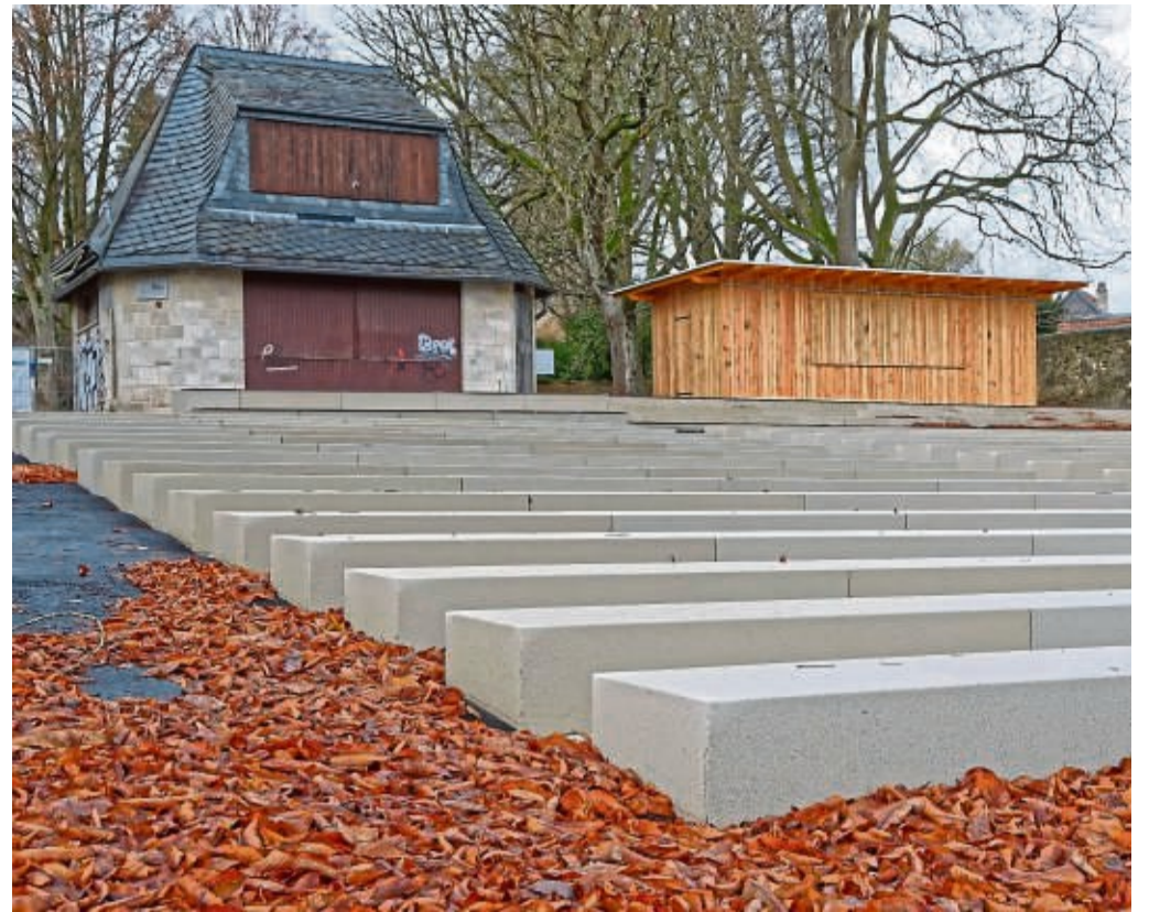
Die neugestaltete Freilichtbühne im Korbacher Schießhagen mit neuem Kiosk und barrierefreier Tribüne. Die Sitzflächen und Rückenlehnen aus Holz fehlen noch. FOTO: LUTZ BENSELER
