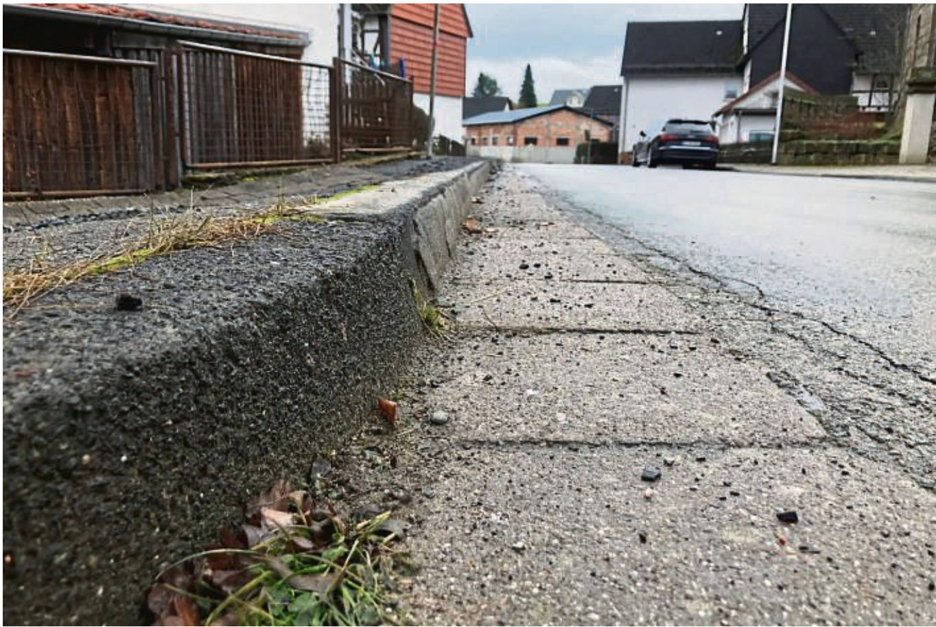
Für Menschen mit einer Gehbehinderung schwierig: Dem Bürgersteig an der Erpetalstraße in Wenigenhasungen fehlen nach Angaben des Behindertenbeauftragten Wolfgang Hensel Absenkungen.
