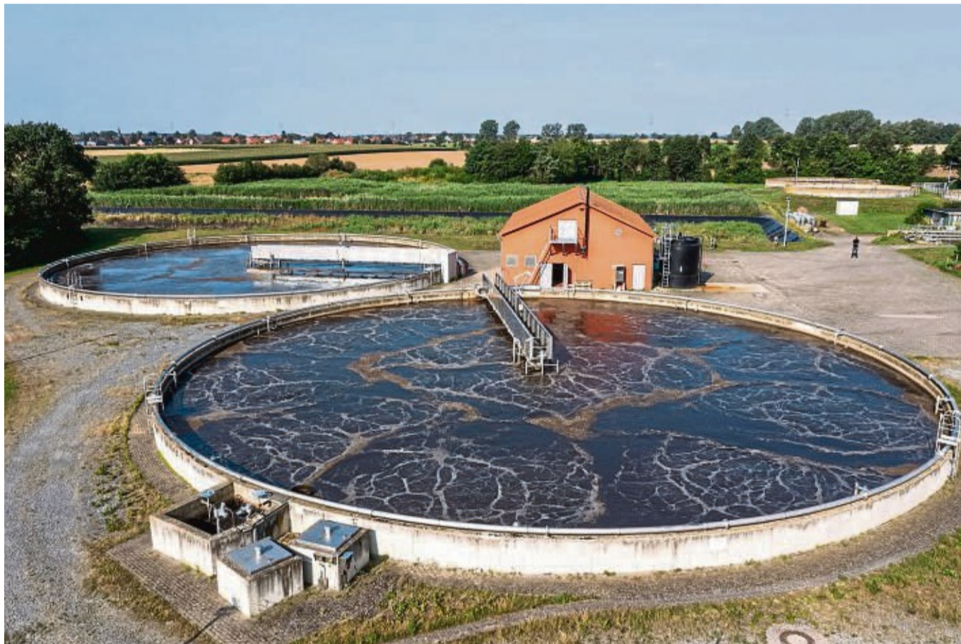
Kläranlagen benötigen viel Energie für den Reinigungsprozess, wie etwa hier beim Sauerstoff-Eintrag ins Belebungsbecken.
