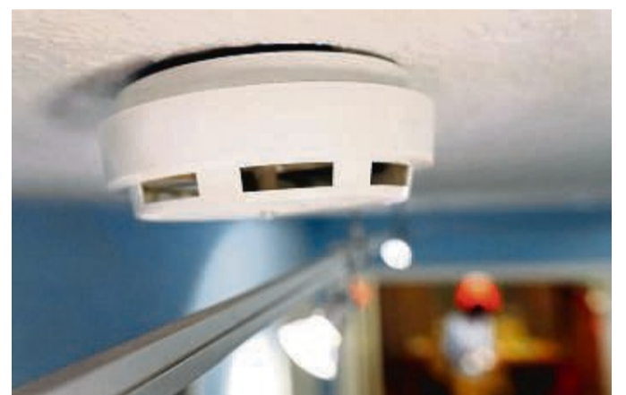
So sehen sie aus: Ein Rauchmelder, aufgenommen in einem Hausflur. FOTO: MARTIN GERTEN/DPA
