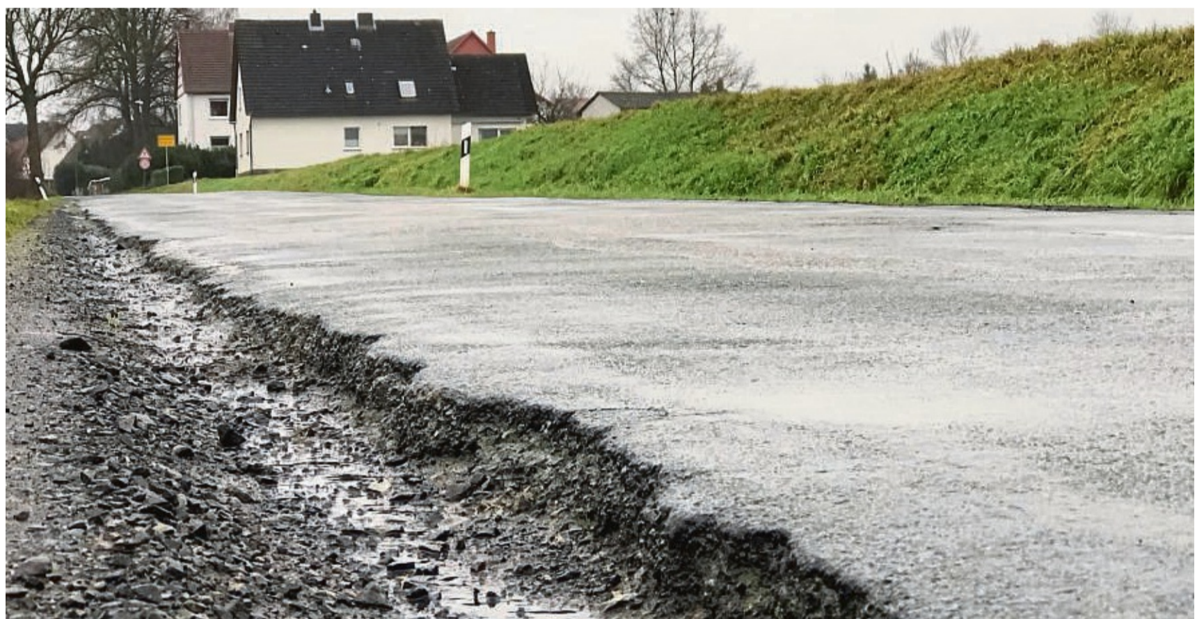
Bröselige Bankette: Die Kreisstraße K100 zwischen Wenigenhasungen und Altenhasungen wird im Sommer saniert. Danach wird sie zur Gemeindestraße.
