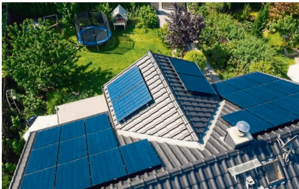
Das verabschiedete Gesetz macht den Kauf und die Installation einer Solaranlage bis 30 Kilowattpeak (kWp) mit null Prozent Mehrwertsteuer möglich. FOTO: ZOLAR
