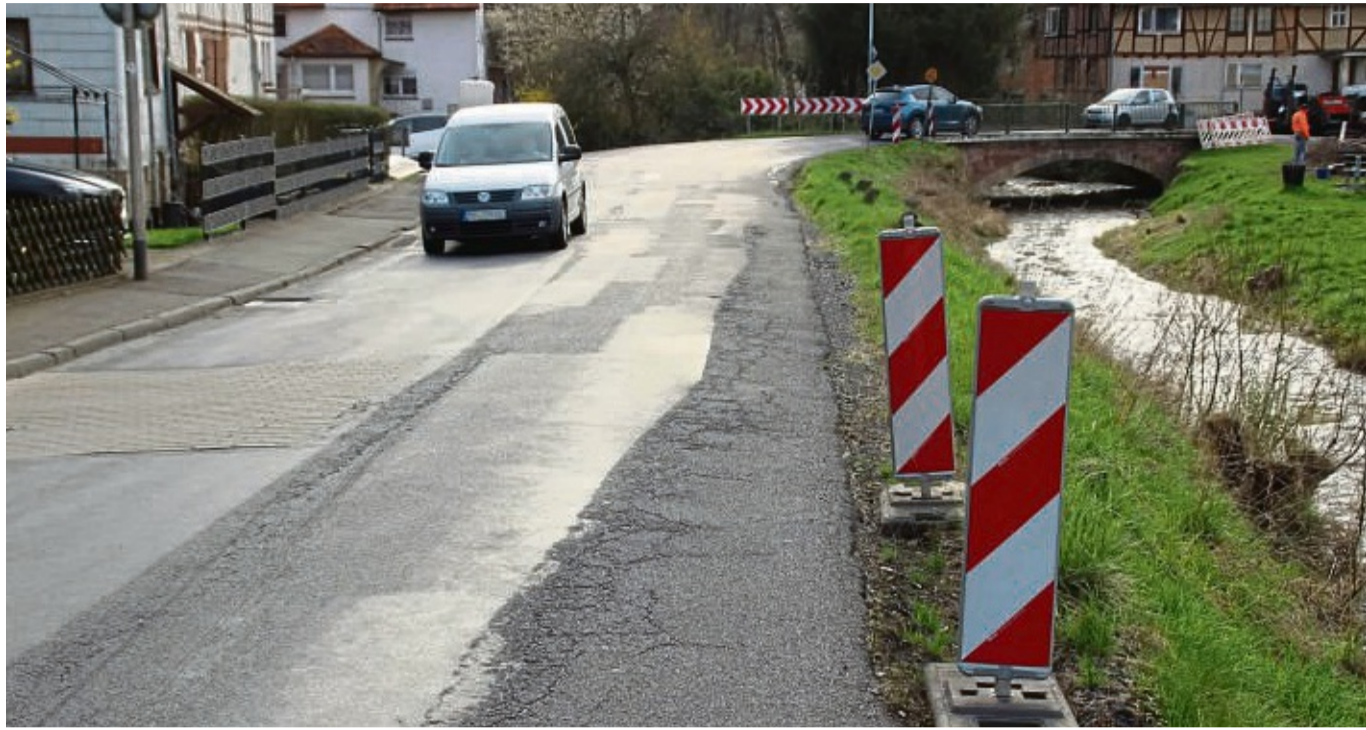
Gefährliche Situation: Zwischen der kaputten Landesstraße und der Mülmisch in Empfershausen sind auch die Seitenstreifen schon lange marode. Warnbaken sind nur ein Provisorium. FOTO: MANFRED SCHAAKE
