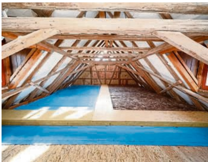
Dämmung der obersten Geschossdecke: Mit einer mineralischen Dämmung, speziell aus Glas- oder Steinwolle, lassen sich hohe Energiekosten einsparen. Zudem schützt Mineralwolle die Hausbewohner ganzjährig vor Brandausbreitung und Schall.
