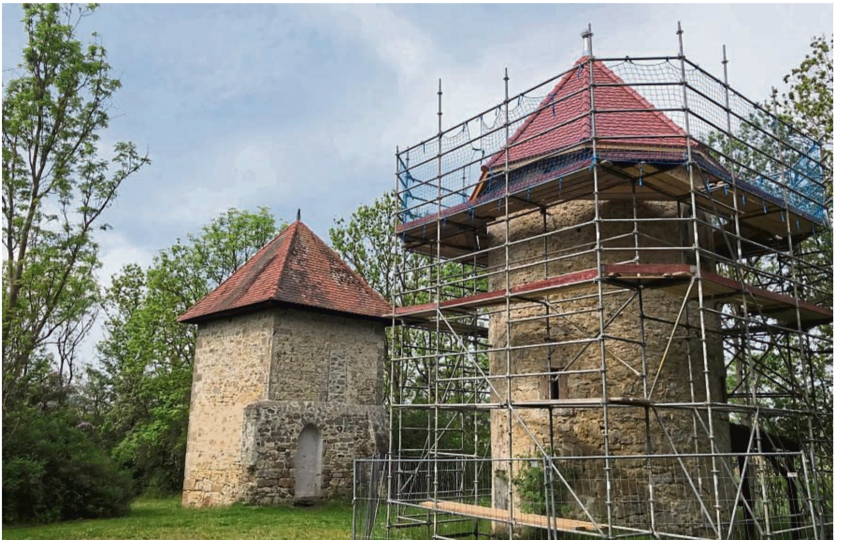
Das Gerüst steht noch: Nach Sturmschäden musste das Dach des rechten Turmes auf dem Graner Berg neu eingedeckt werden.
