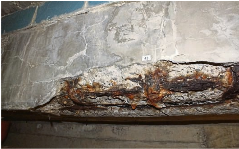
In den Katakomben des Heloponte: Bilder vom Zustand, wie dieses, bekamen die Stadtverordneten zu sehen. FOTOS: PR
