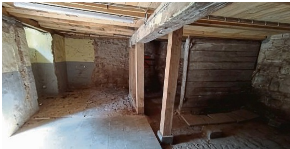
Keller im Schlossturm: Dort sind Exponate des Heimatmuseums untergebracht. Er sei aber feucht, kritisiert der Heimatverein.
