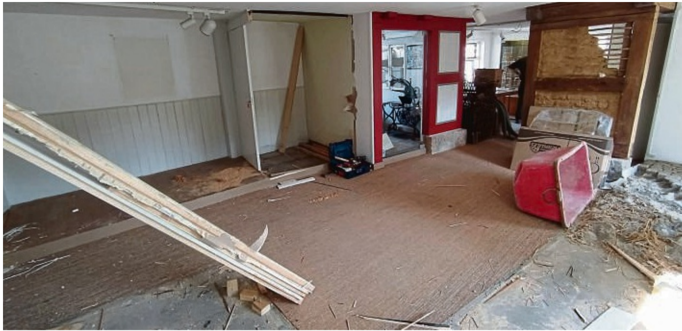
Ansicht des Museums: So sieht es aktuell im Schleusenhaus an der Bartenwetterbrücke nach der Räumung aus.
