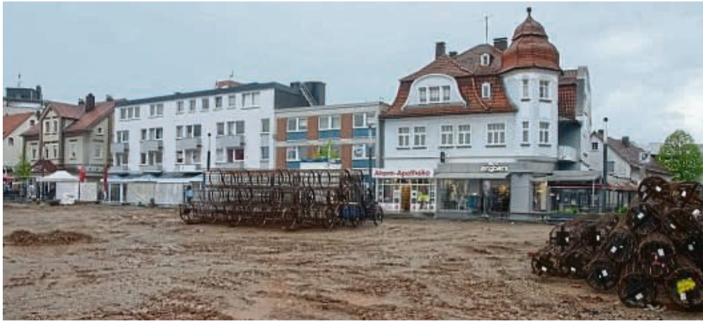
Die Baustelle auf dem ehemaligen Woolworth-Gelände in Korbach ruht: Das große Bohrgerät soll Ende des Monats wieder anrücken.
