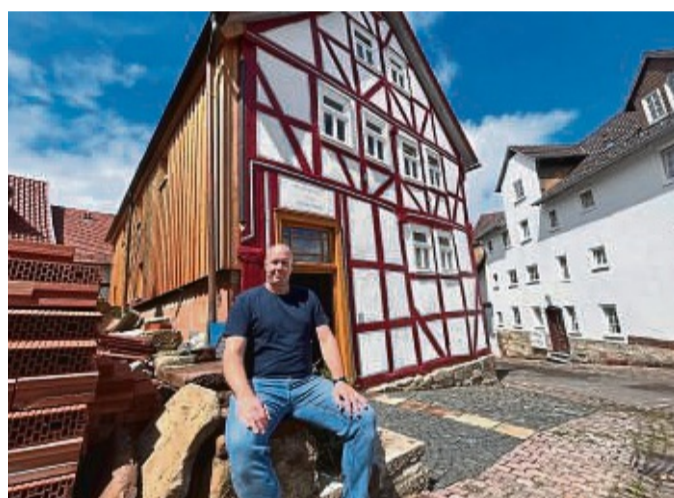
Außen ist alles schon schön: Matthias Paar vor dem Fachwerkhaus im Renthof 4, das er seit drei Jahren mit seiner Familie saniert. FOTOS: CHRISTINE THIERY
