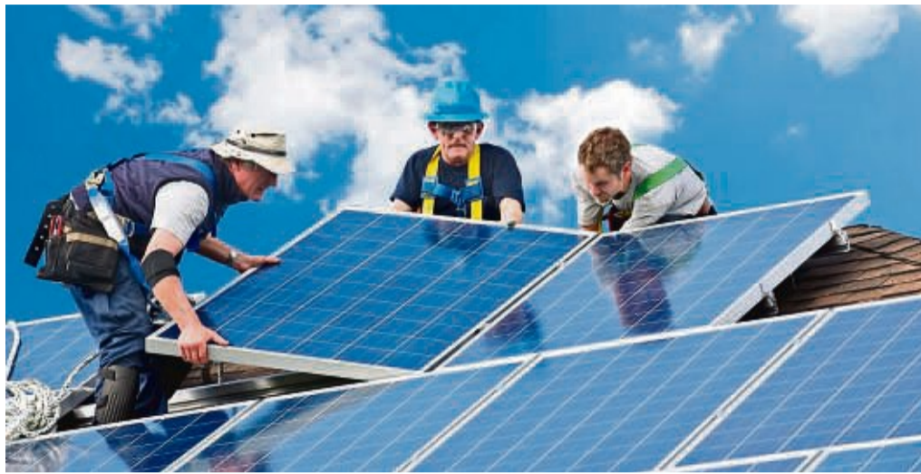
Mit dem richtigen Partnerunternehmen an der Seite, gelingt die Installation einer neuen Photovoltaikanlage problemlos. FOTO: PANTHERMEDIA / ELENA ELISSEVA
