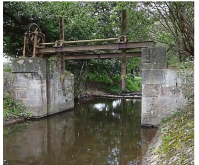
Die Schwelle am Wehr ist ebenso verschwunden wie der Absturz und das Tosbecken dahinter. FOTOS: THOMAS THIELE
