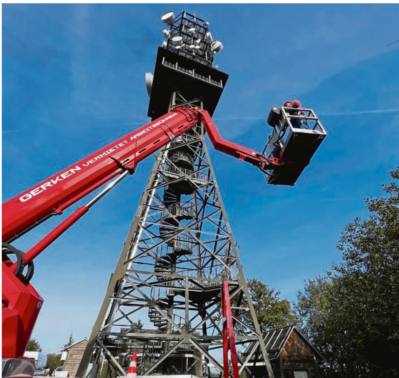
Mit dem Hubwagen zur Reparatur: Die Schlosser reparieren Korrosionsschäden am Turm auf dem Großen Bärenberg.
