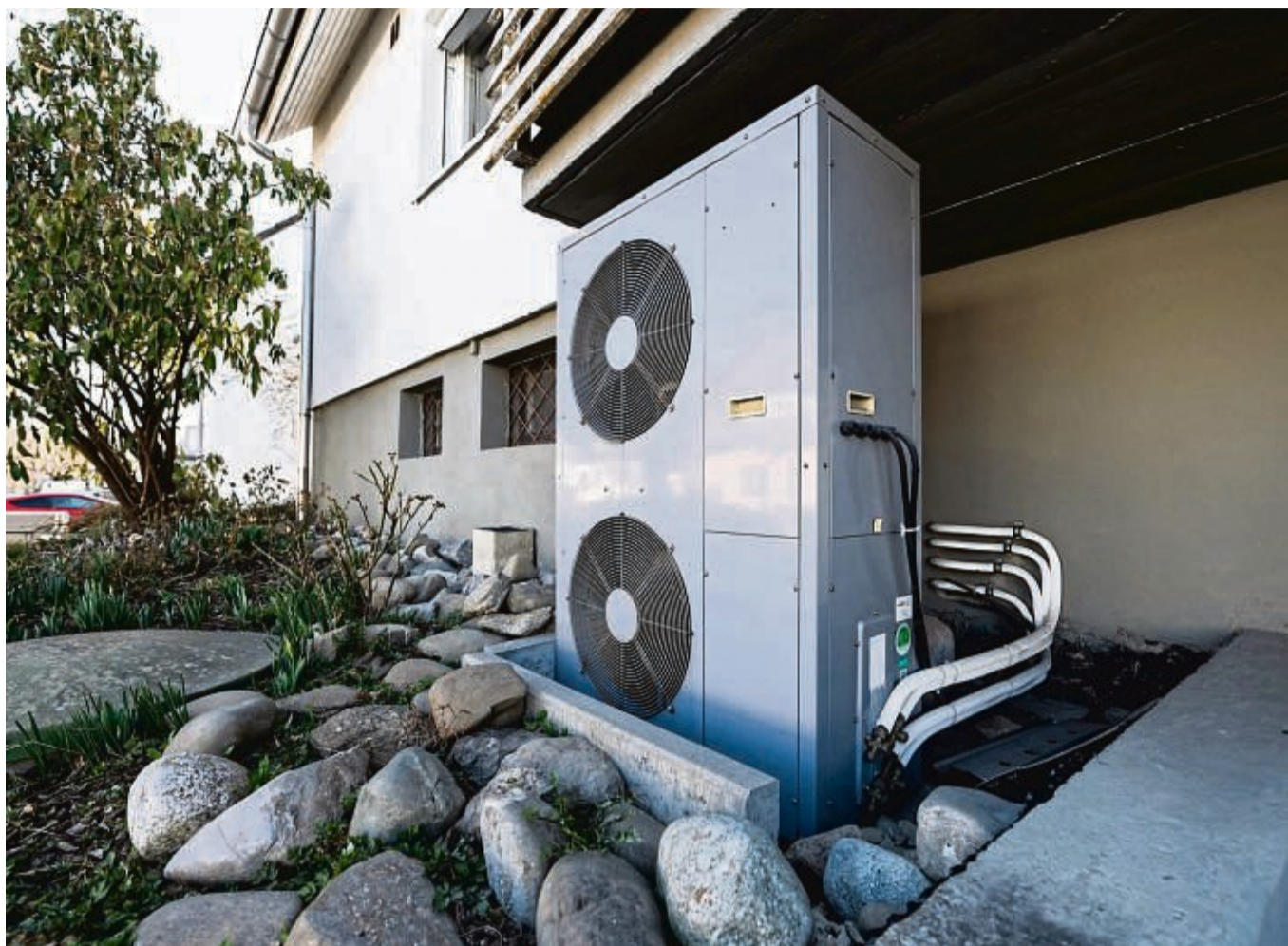
Eine moderne Wärmepumpe kann auch der Wohnungseigentümergeinschaft helfen, langfristig fossile Brennstoffe zu sparen und Betriebskosten zu reduzieren.
