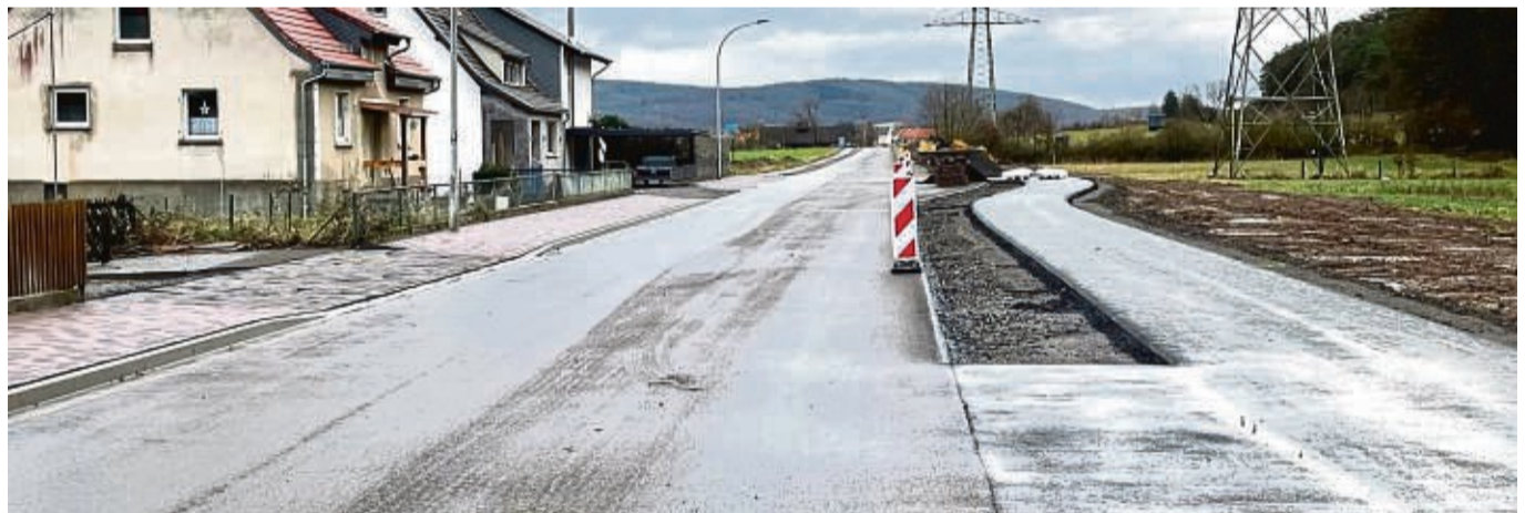
Viel befahrener Zubringer zum Edersee: Die Bauarbeiten an der L 3086 wurden nicht wie geplant im Dezember abgeschlossen.
