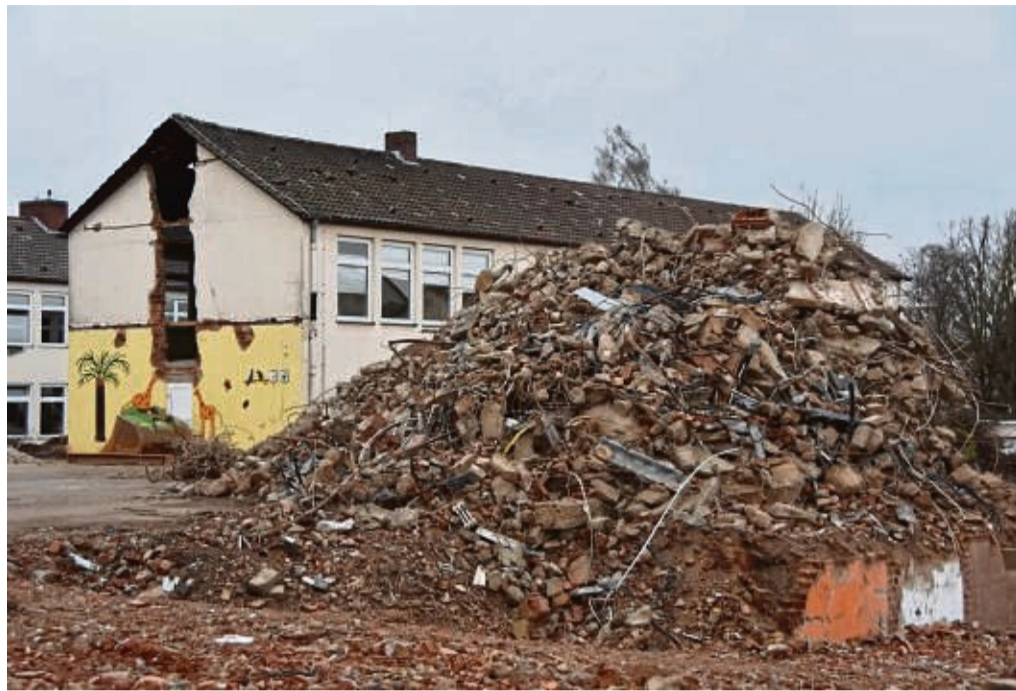
Schutthaufen: Das erste von vier Gebäuden der Berliner Schule ist abgerissen worden. Zwei weitere folgen in den kommenden Wochen. Wenn die Schüler in den Neubau umgezogen sind, wird auch das Hauptgebäude abgerissen.
