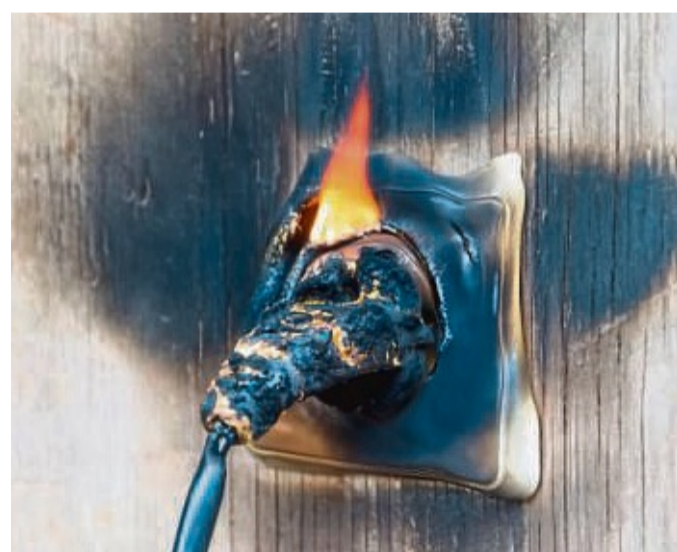
Kabelbrände sind oft eine Auswirkung veralteter oder überlasteter Elektroanlagen. FOTO: SHUTTERSTOCK - DMITRY-P-K / ARGE MEDIEN IM ZVEH
