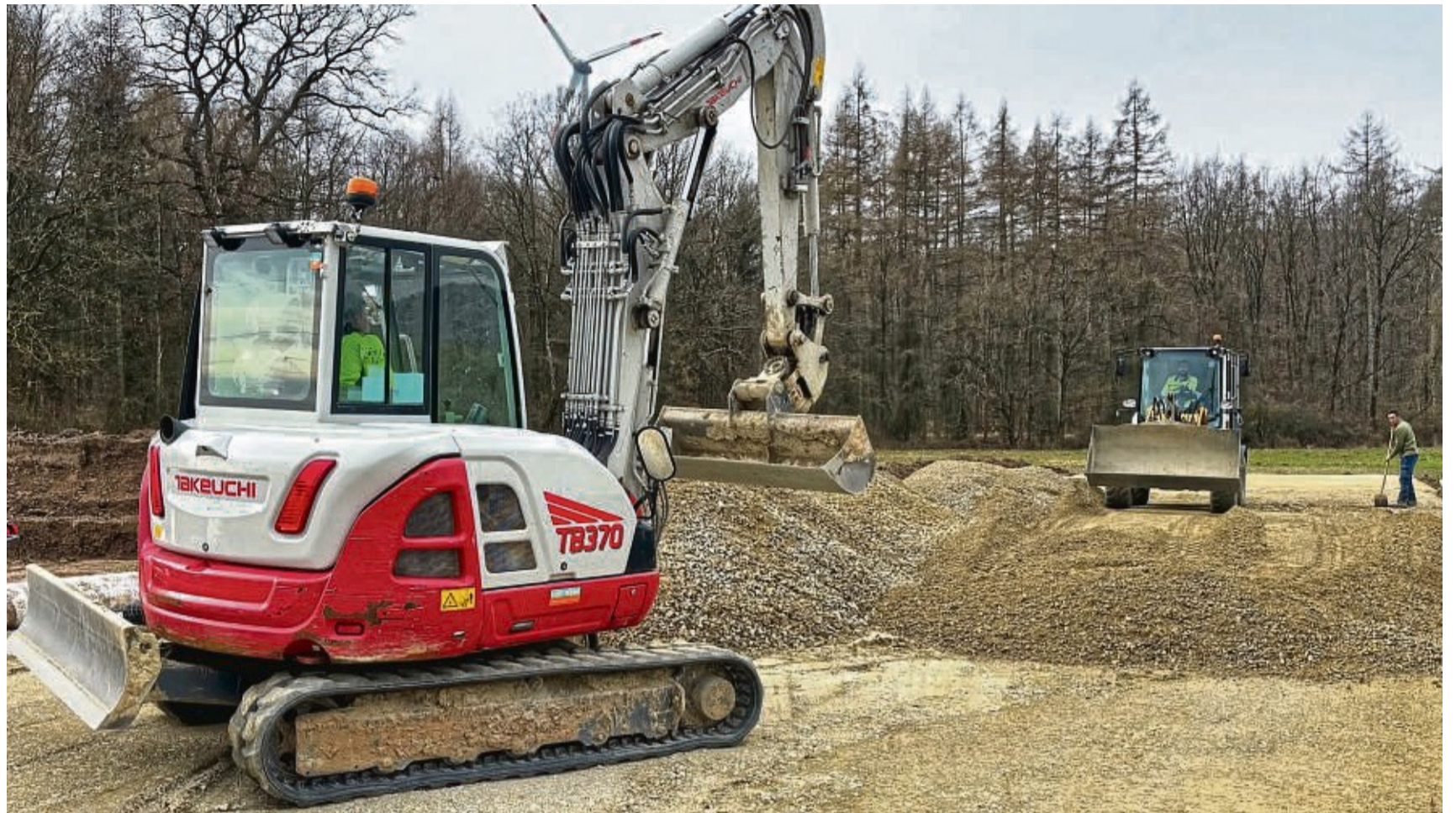
Bagger und Radlader im Einsatz: Derzeit werden auf einem Grundstück neben der Straße zwischen Nothfelden und Niederelsungen die vorbereitenden Arbeiten erledigt, um im April die beiden Trafos ins Umspannwerk integrieren zu können.
