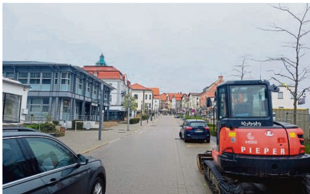
Ab heute kommt es bis in den Juni hinein im Bad Wildunger Scharnert zu Behinderungen und Sperrungen für den Verkehr. Grund sind Arbeiten an Rampen und Rinnen des Pflasters. FOTO: MATTHIAS SCHULTZ
