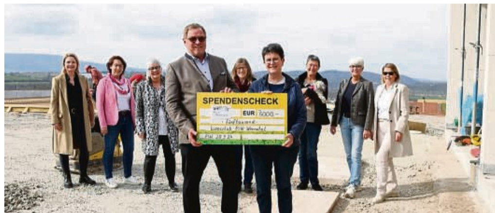
Auf der Baustelle überreicht Rüdiger Siegel den Spendenscheck an Andrea Bräutigam. Mit dabei: (hinten, von links) Tanja Siebert, Dr. Angela Köhler, Heike Nölke, Gudrun Kühnemuth, Lena Sickmann, Simone Baumeister und Martina Hossbach. FOTO: EDEN SOPHIE RIMBACH
