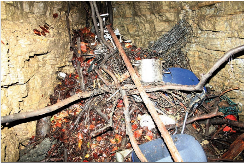
Holz und Müll am Grunde des Schachtes im September 2008.
