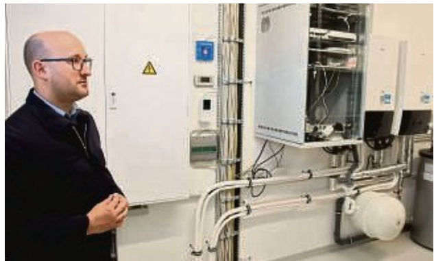
Rundgang: André Wagner, Gerätewart der Feuerwehr Kelze, erklärt die Ausstattung des Gebäudes. Dazu gehört auch der Technikraum im Obergeschoss.
