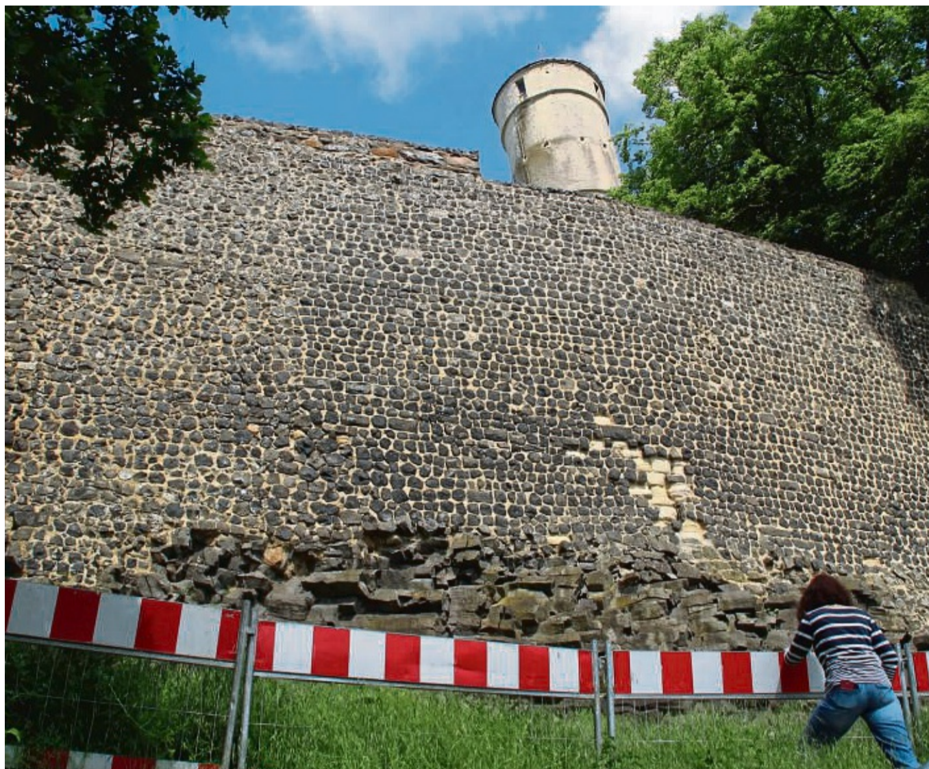
Absperrungen am Südhang der Felsburg: Die Verwaltung der Staatlichen Schlösser und Gärten spricht von einer Vorichtsmaßnahme, weil sich Risse und Fugenerweiterungen im Basalt gebildet haben. Direkt über dem Säulenbasalt haben die Erbauer der Felsburg mit dem Mauern der Wände begonnen – fast alles Material, das man an Ort und Stelle fand. Es wurde aber auch heimischer Sandstein verwendet.
