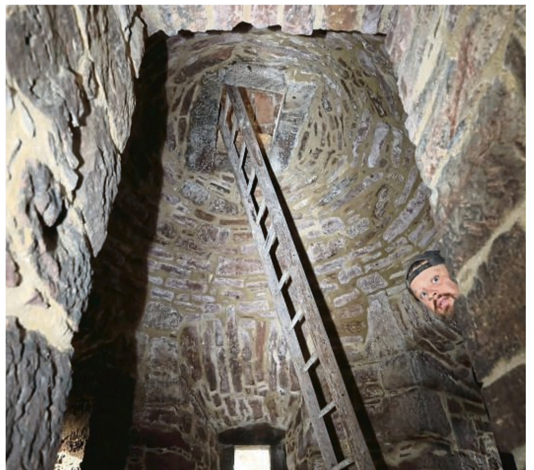
Im mittleren Geschoss wurde das Gewölbe erneuert. Eine Leiter bleibt einzige Aufstiegsmöglichkeit.
