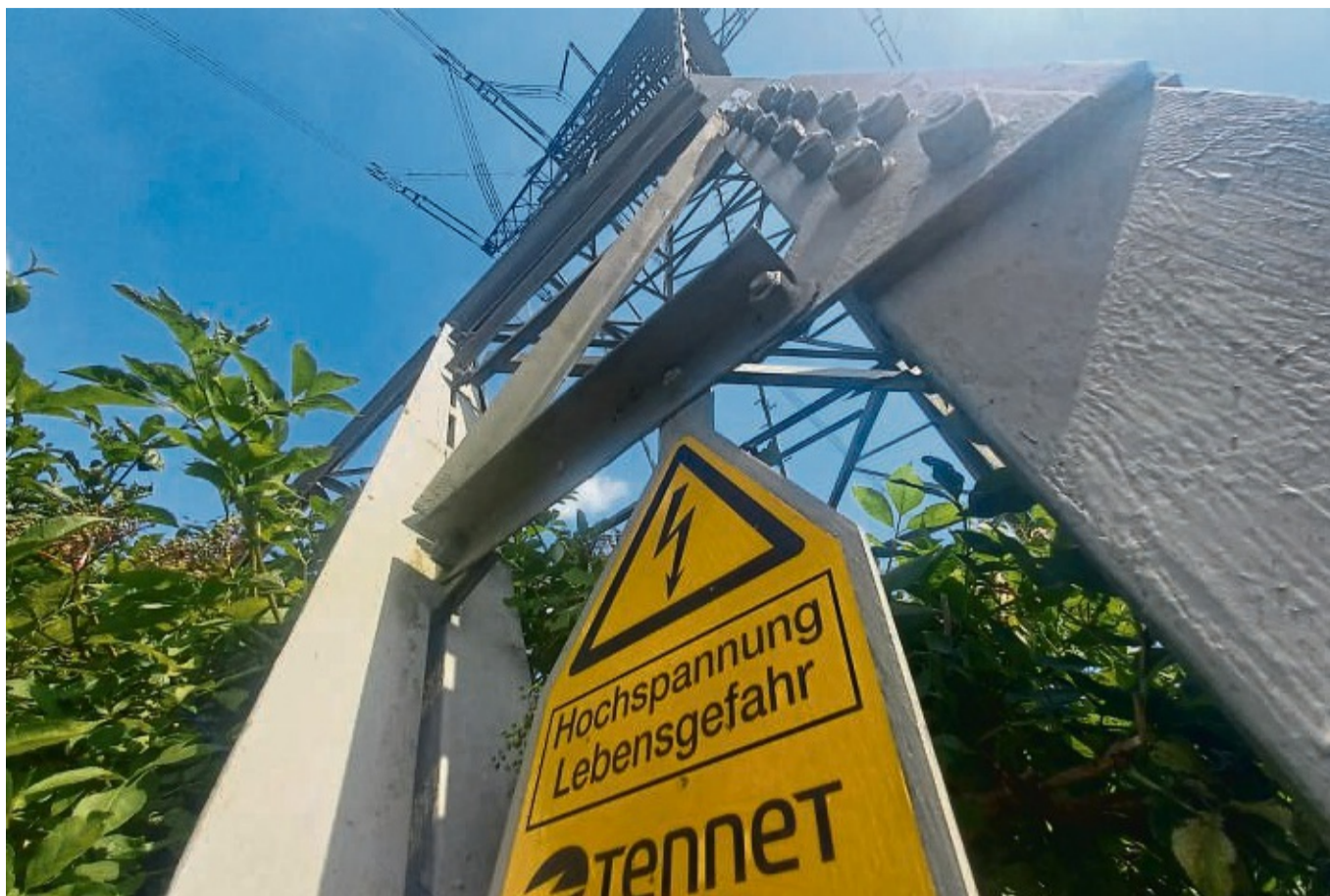
Für eine sichere Stromversorgung: Tennet hat seine Überlandleitungen in der Region ertüchtigt (hier am Gifflitzer Berg). Der Konzern plant nun ein großes Umspannwerk.
