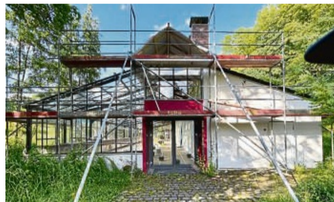
Eingerüstet: Das Glashaus im Kurpark wird saniert. Bauabschluss ist voraussichtlich im September.
