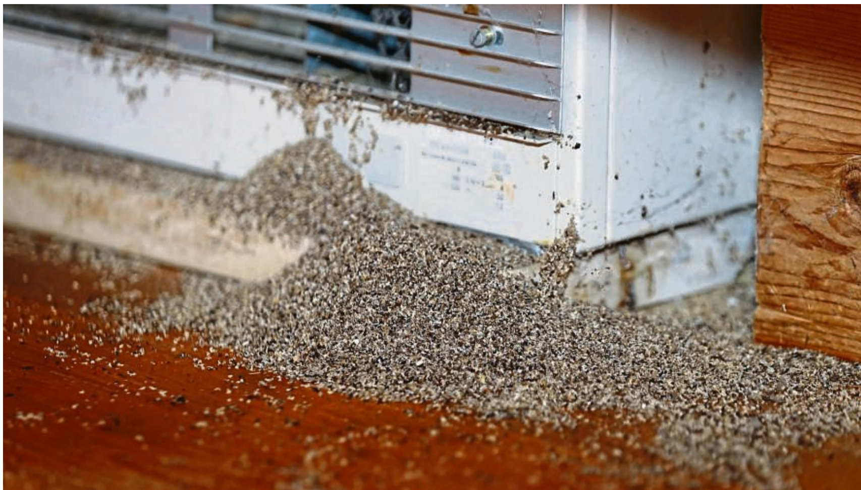
Geraten Ameisen erst einmal in die Elektrik, Kabelkanäle oder die Heizungen, sind in der Regel Profis gefragt.
